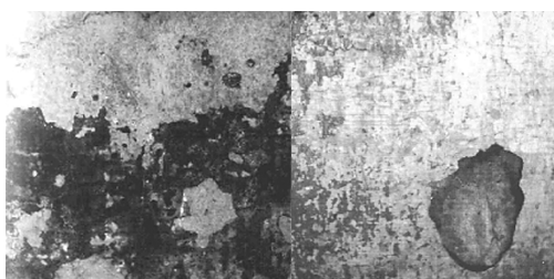
Figura 15 – Descolamento de pintura e da argamassa
