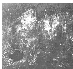
Figura 16 – Eflorescência e manchas
